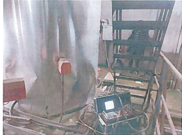
2#排气筒 DA002 (◎2) 有组织排放废气
